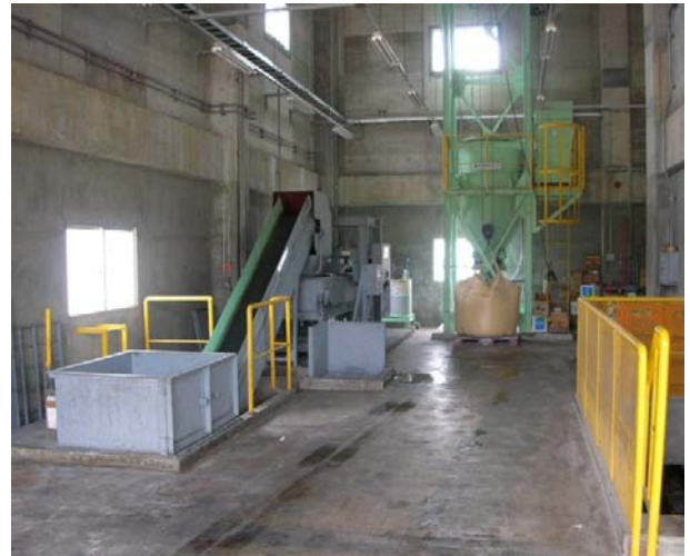
リサイクル設備
