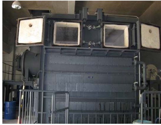
焼却炉（上部が投入口）
