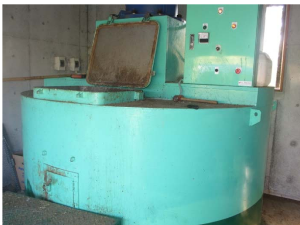
生ごみたい肥化用機械設備(草木類と生ごみを混合して堆肥化)
